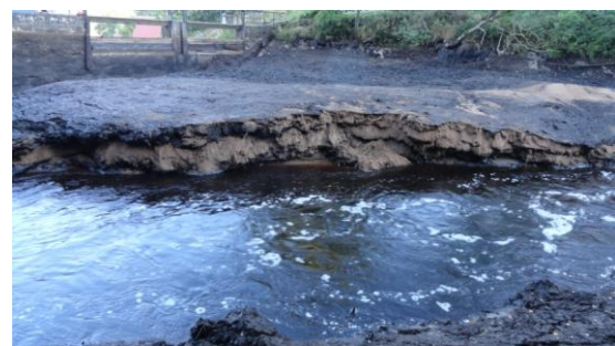
Figur 8: Dammen är nästan helt tömd på vatten. Det grövre material som samlats närmast den ursprungliga fåran utgörs av sand.
